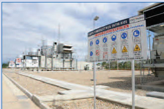
Fotos 4 y 5. Sub estación de la termoeléctrica y señalética de prevención cerca de las turbinas.
