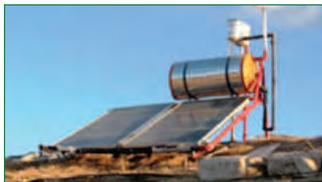
Foto 4. Usando la energía solar para calentar el agua
