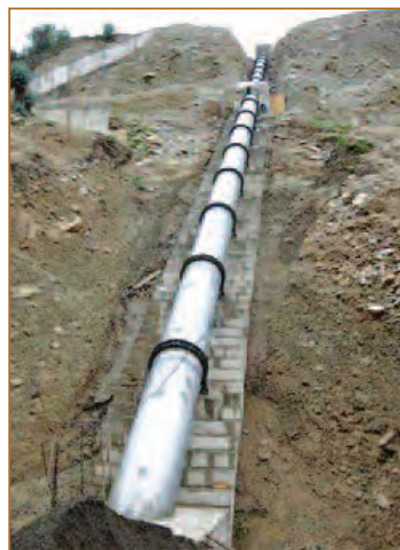
Foto 4. Tubería de presión de acero, PCH en Perú (Fuente: GCZ Ingenieros SAC).
