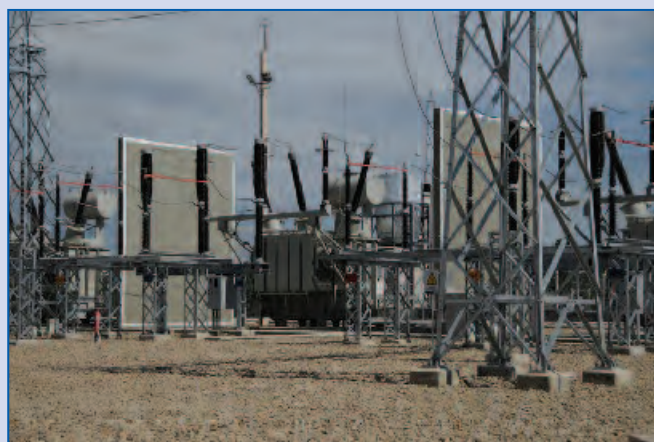
Fotos 3. Sub estación Planta Entre Ríos.
