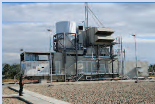
Foto 6. Una de las cuatro turbinas de 25 MW de potencia.
